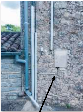
Sortie du câble d'alimentation
